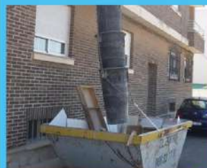
Ductos para la descarga de RCD's
