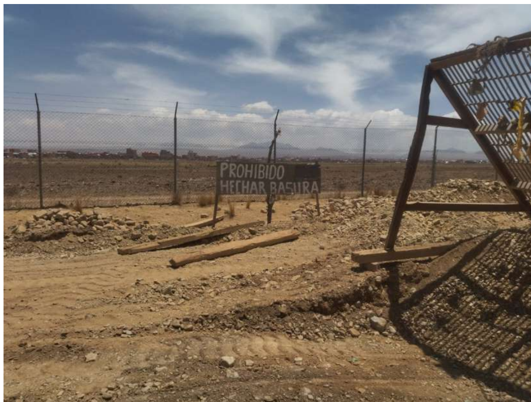
Acumulación de residuos asimilables a domiciliarios dentro la obra.
